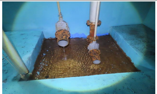
배수지 1지 유출 관 부식
