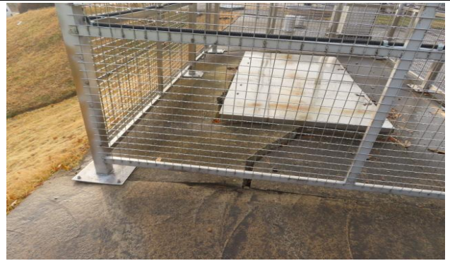
금회 정밀안전점검 파손
