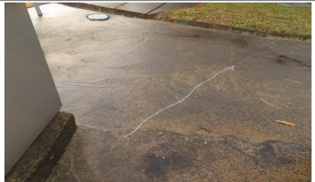
배수지 상부슬래브 균열(0.3mm이상)
