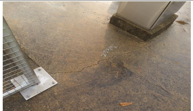
배수지 상부슬래브 균열(1.0mm이상)
