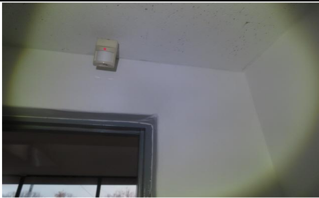
전기실 내부 벽체 균열(0.3mm이상) 보수완료
