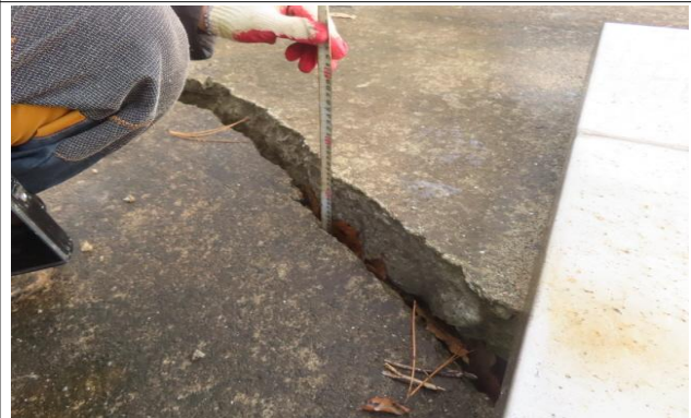
외관조사 손상 크기측정
