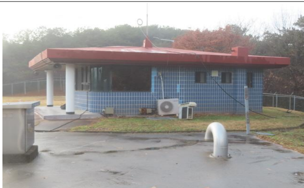
전기실 외부 전경
