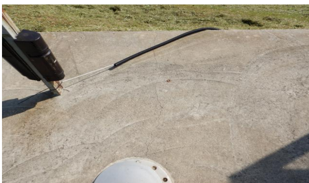
21년 정밀안전점검 균열(0.3mm이상)
