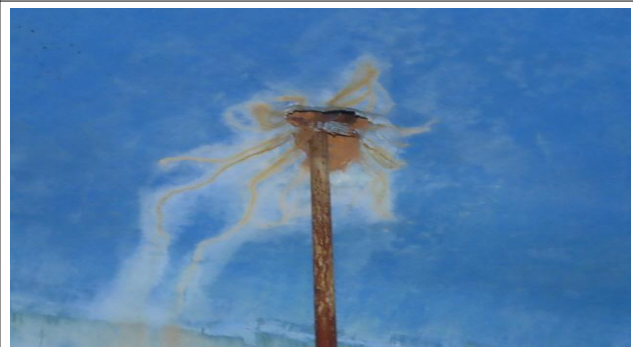
배수지 1지 상부슬래브 철근노출
