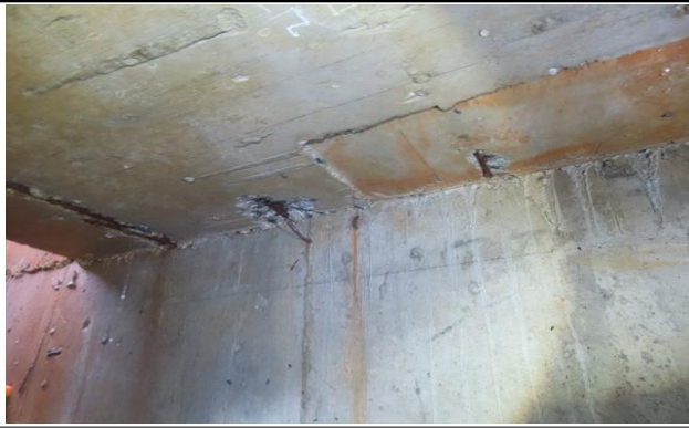
유출밸브실 상부슬래브 철근노출
