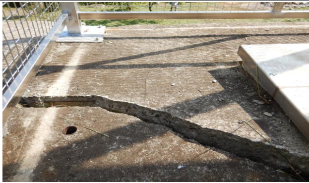
21년 정밀안전점검 파손
