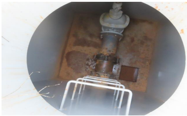
드레인실 내부 전경
