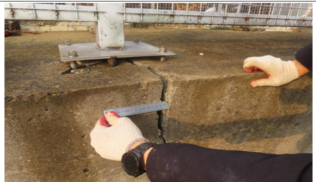
금회 정밀안전점검 파손(폭=15mm)
