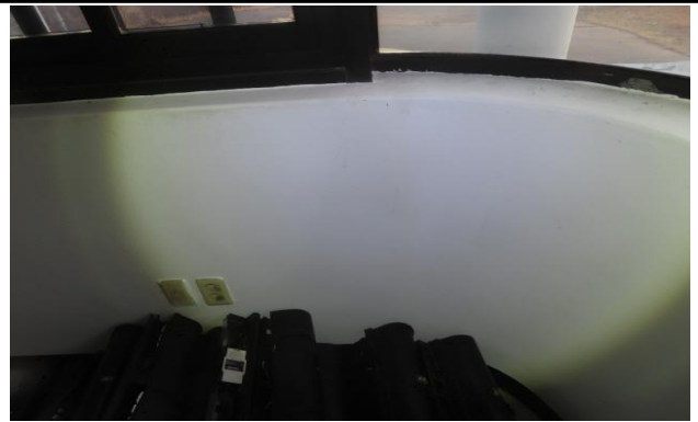
전기실 내부 벽체 균열(0.3mm이상) 보수완료
