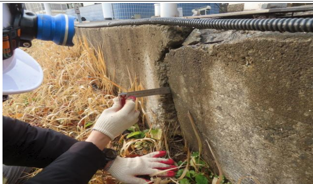
금회 정밀안전점검 파손(폭=30mm)
