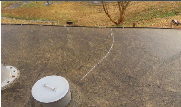
배수지 상부슬래브 균열(0.3mm미만)
