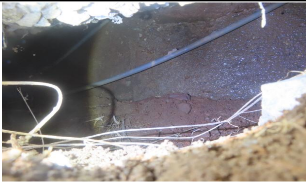
금회 정밀안전점검 파손 (공동)
