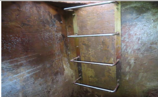
유입 밸브실 사다리 상태양호
