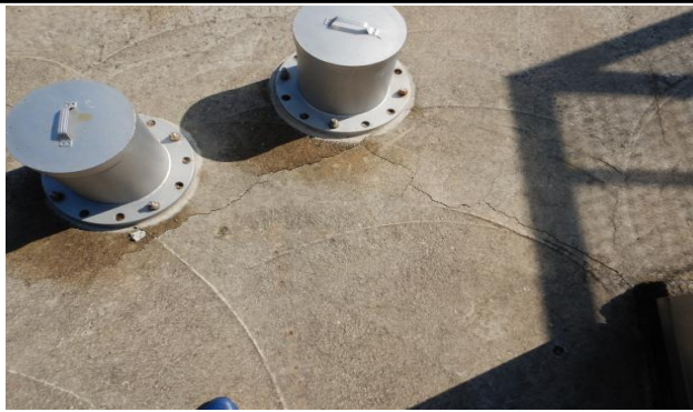
21년 정밀안전점검 균열(0.3mm미만)
