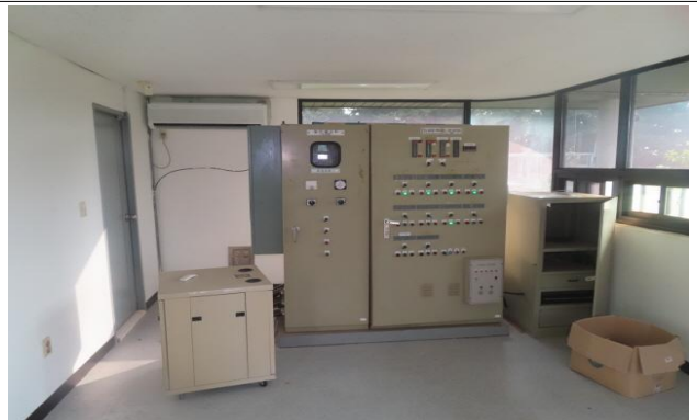
전기설비 원격제어판넬 상태양호
