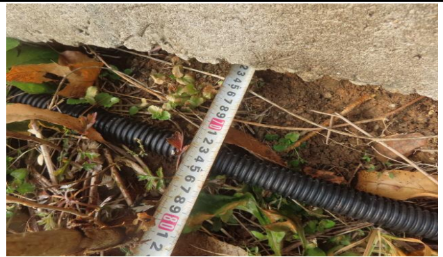
금회 정밀안전점검 파손 (깊이=620mm)
