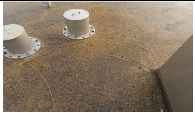
금회 정밀안전점검 균열(0.5mm이상)
