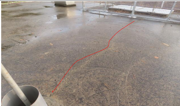
배수지 상부슬래브 균열(1.0mm이상)
