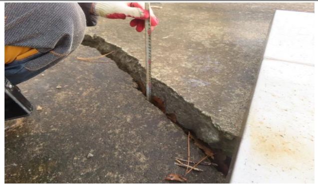
금회 정밀안전점검 파손(깊이=600mm)
