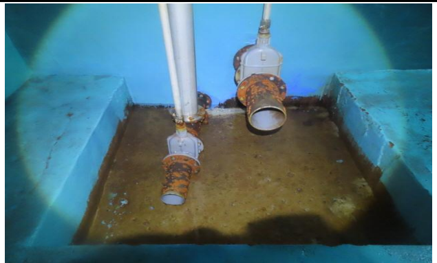
배수지 2지 유출 관 부식
