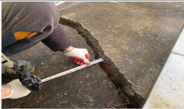
금회 정밀안전점검 파손(폭=40mm)
